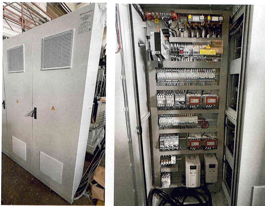
Рисунок 1.3 – Фотографии общего вида шкафа 2 ИФДС5996-80.10.02.000 из состава системы
