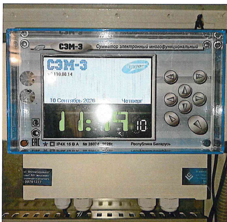
б) сумматор в шкафу АСКУЭ
