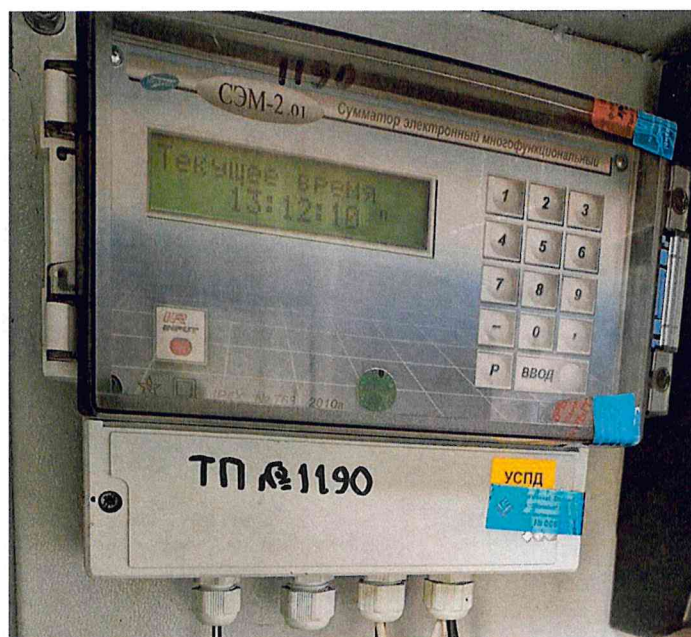
б) сумматор в шкафу АСКУЭ
