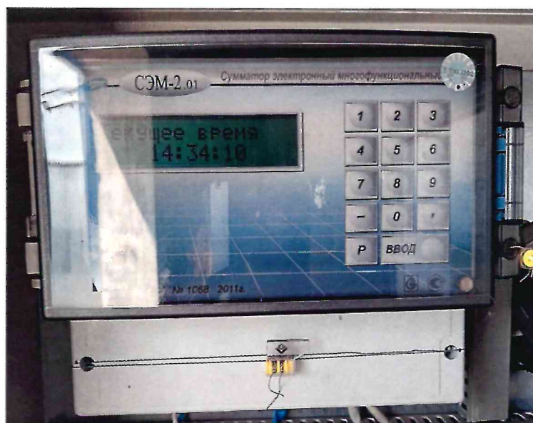
б) сумматор в шкафу АСКУЭ
