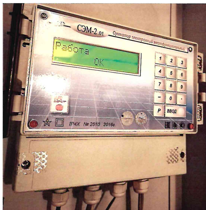
б) сумматор в шкафу АСКУЭ
