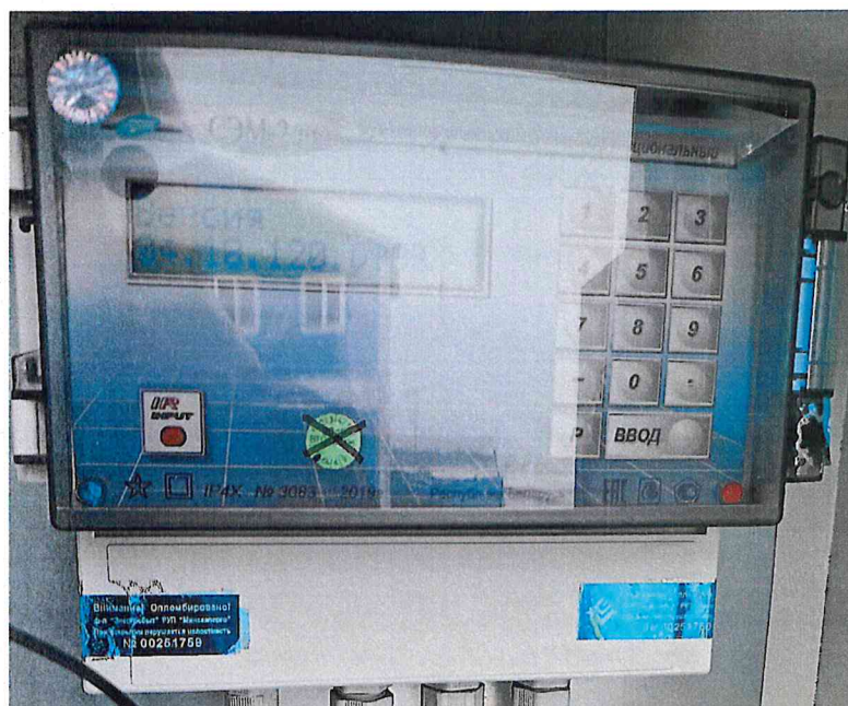
б) сумматор в шкафу АСКУЭ
