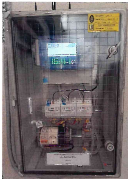
а) шкаф АСКУЭ
