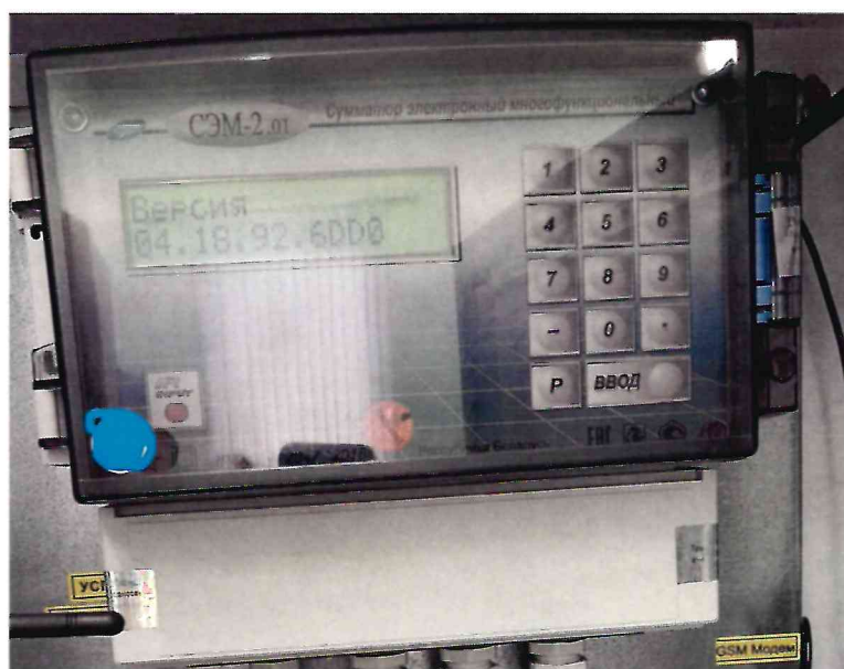
б) сумматор в шкафу АСКУЭ
