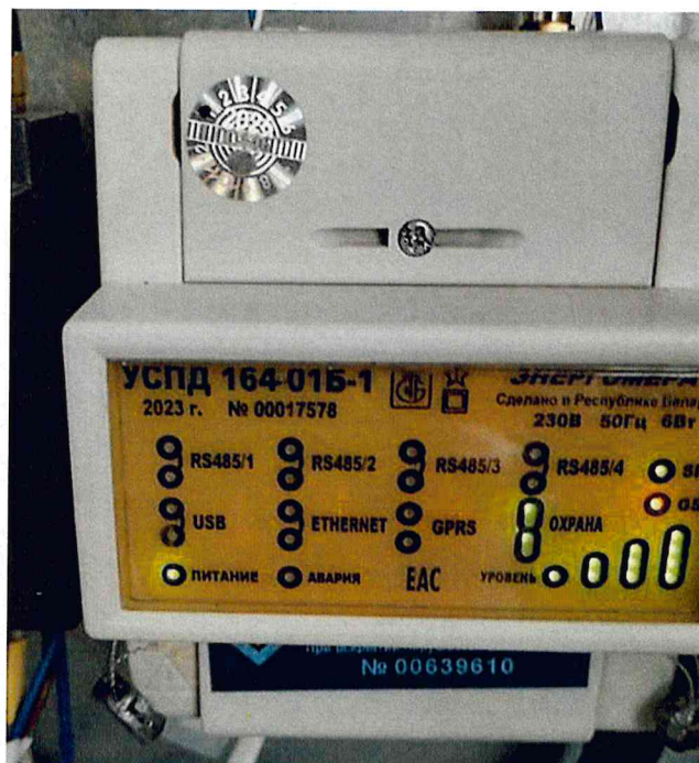
б) УСПД в шкафу АСКУЭ
