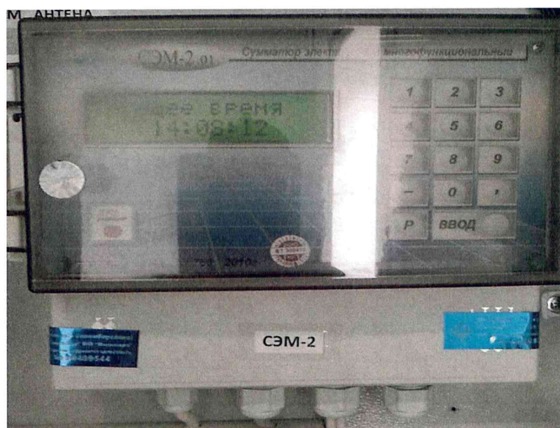
б) сумматор в шкафу АСКУЭ
