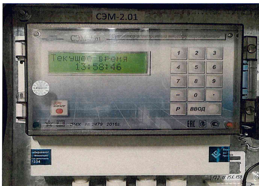
б) сумматор в шкафу АСКУЭ
