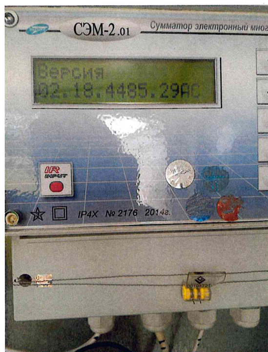
б) сумматор в шкафу АСКУЭ
