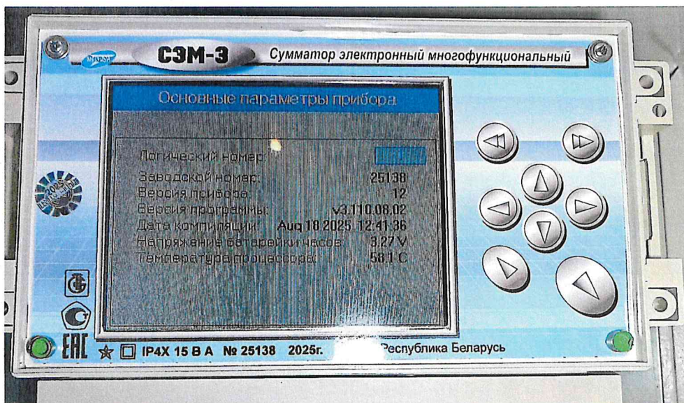
б) сумматор в шкафу АСКУЭ
