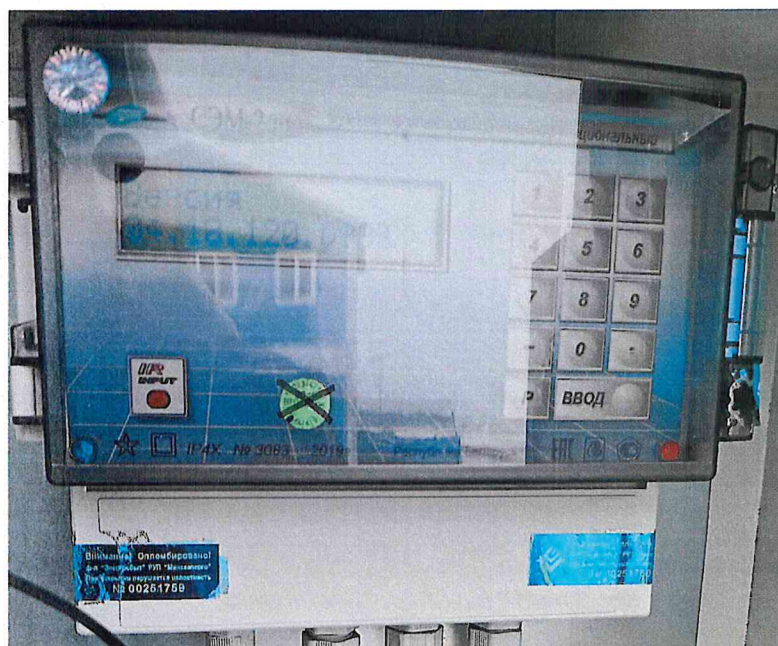
б) сумматор в шкафу АСКУЭ
