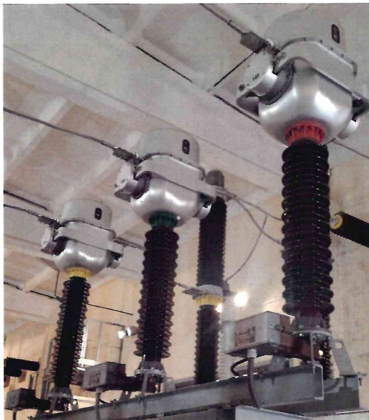
Рисунок 1.1 – Фотографии внешнего вида трансформатора тока СА-123 № 0512098/4
