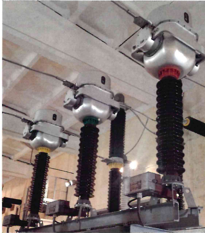
Рисунок 1.1 – Фотографии внешнего вида трансформатора тока СА-123 № 0512098/3
