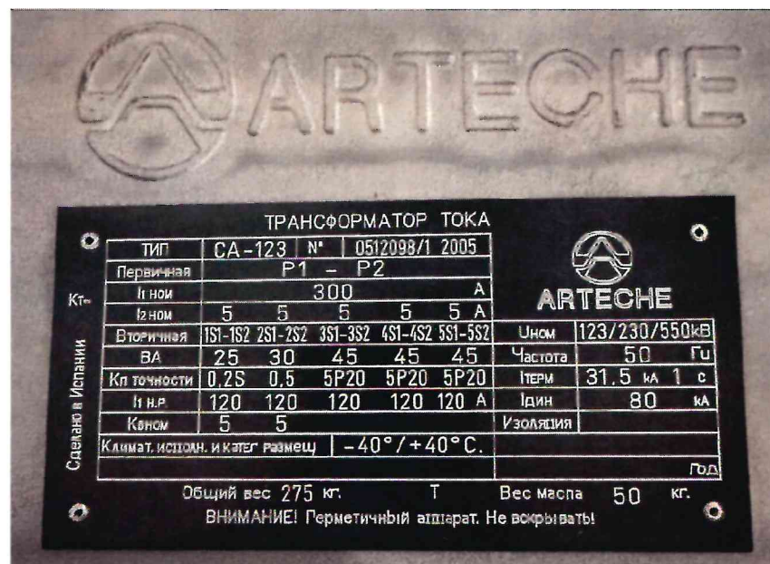
Рисунок 1.2 – Фотография маркировки трансформатора тока СА-123 № 0512098/1
