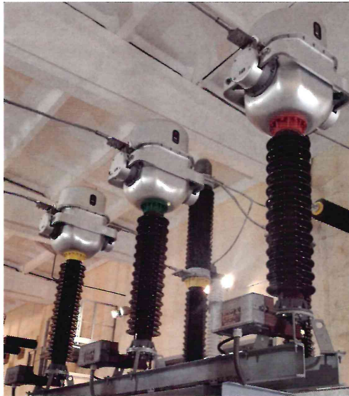
Рисунок 1.1 – Фотографии внешнего вида трансформатора тока СА-123 № 0512098/1
