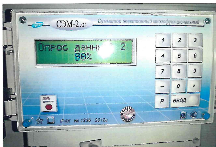
б) сумматор в шкафу АСКУЭ
