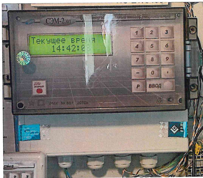
б) сумматор в шкафу АСКУЭ
