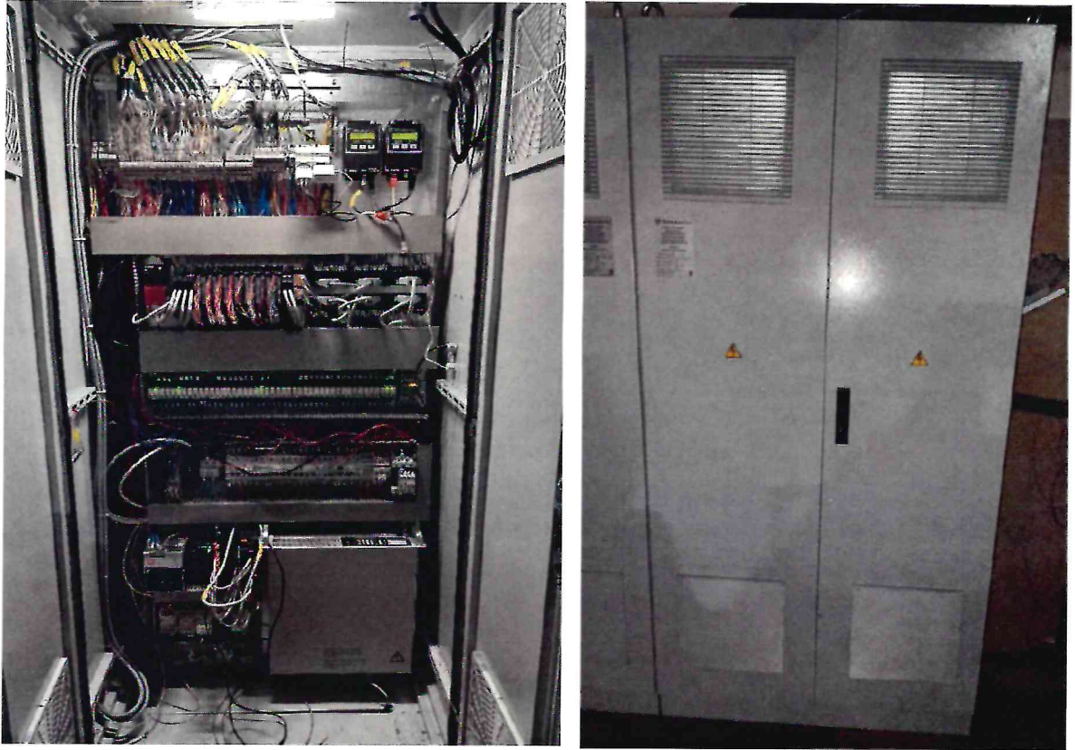
Рисунок 1.2 – Фотографии шкафа 2 ИФДС5518-80.32.00.000 системы
