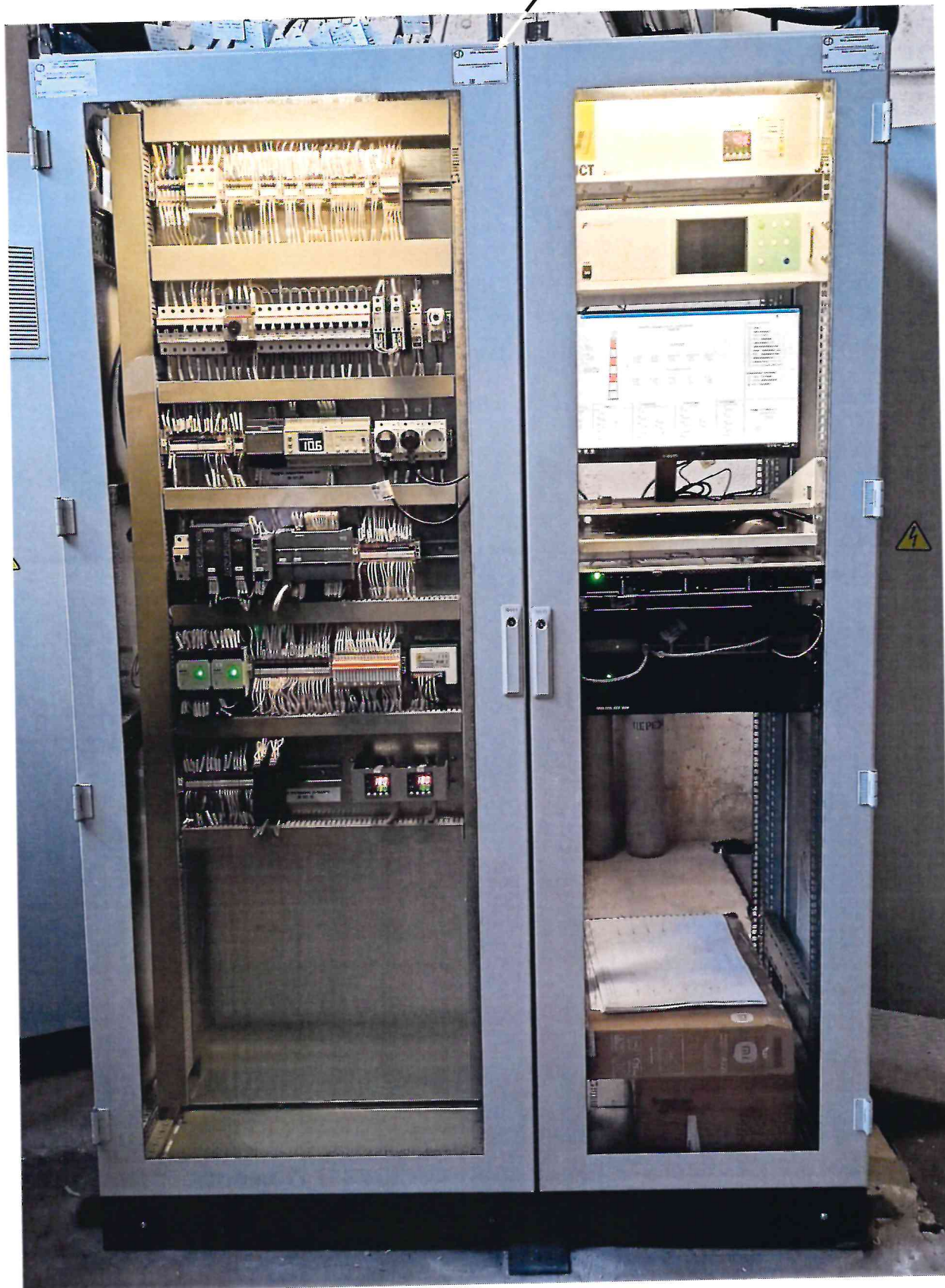
Рисунок 1.10 – Общий вид шкафа с аналитическим и коммутационным оборудованием системы
