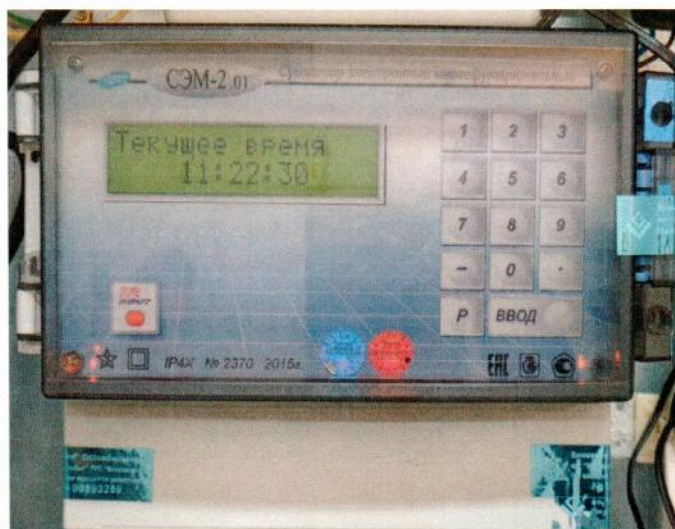
б) сумматор в шкафу АСКУЭ
