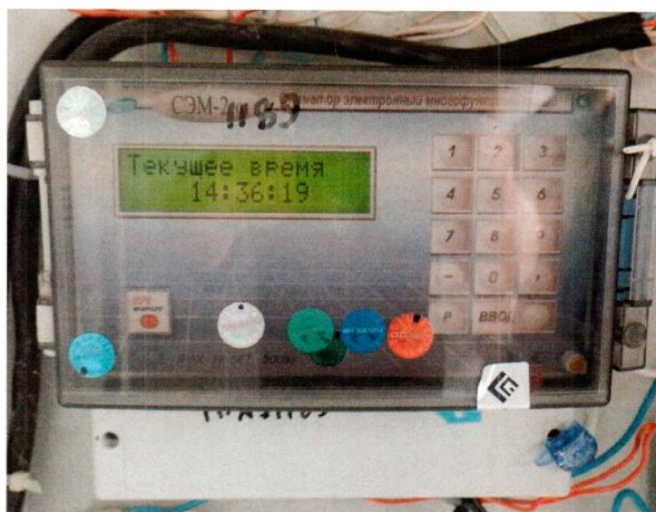
б) сумматор в шкафу АСКУЭ
