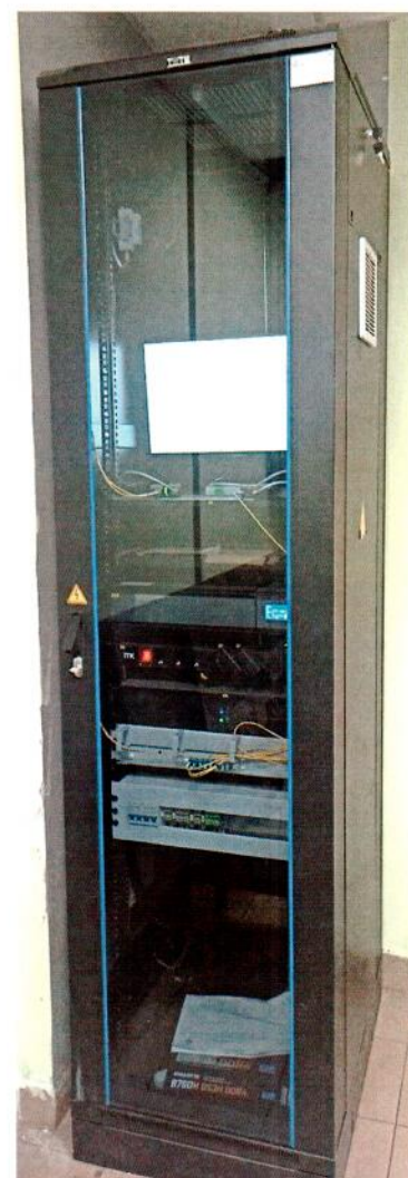
в) сервер АСКВ в серверном шкафу
