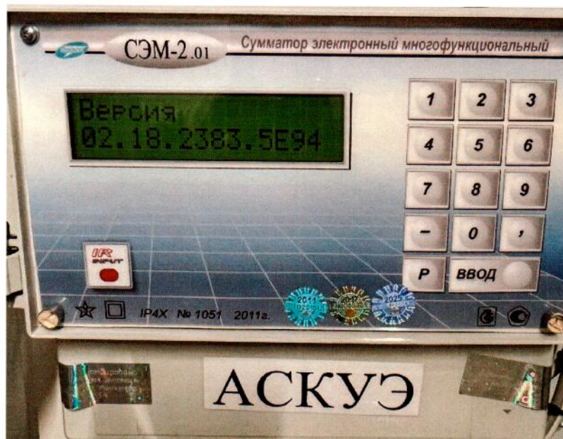
б) сумматор в шкафу АСКУЭ
