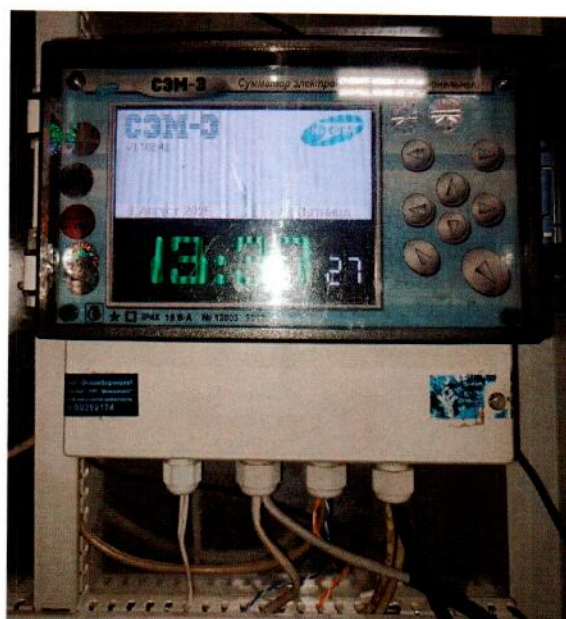
б) сумматор в шкафу АСКУЭ
