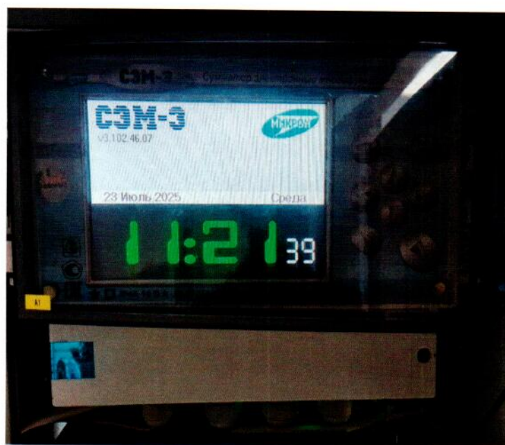
б) сумматор в шкафу АСКУЭ
