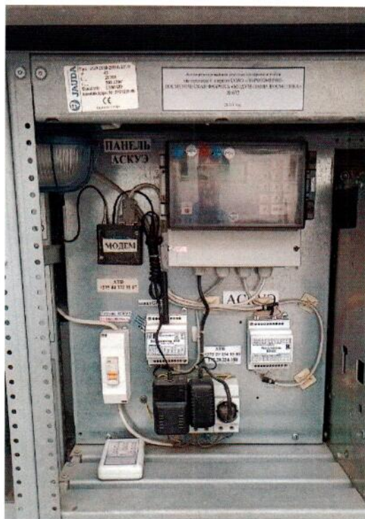
а) шкаф учёта АСКУЭ
