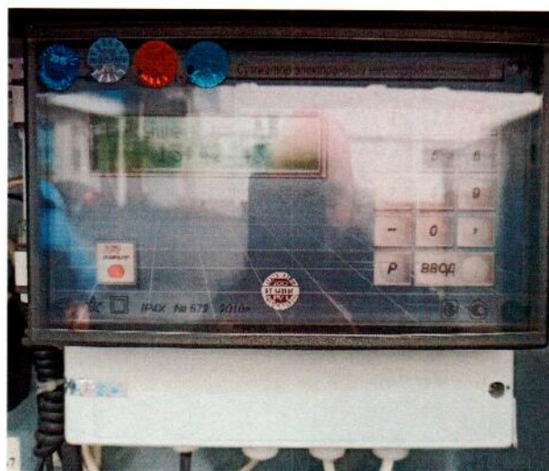
б) сумматор в шкафу учёта АСКУЭ
