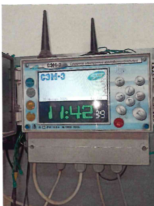
б) сумматор в шкафу АСКУЭ
