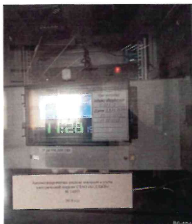
а) шкаф АСКУЭ
