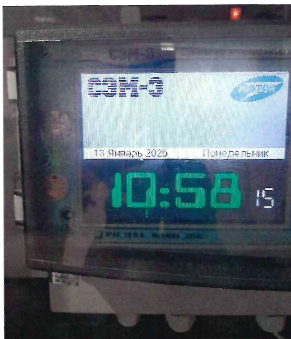
б) сумматор в шкафу АСКУЭ
