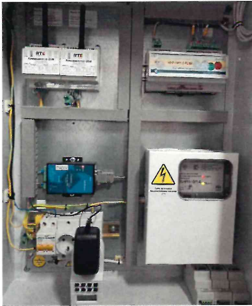
а) шкаф АСКУЭ
