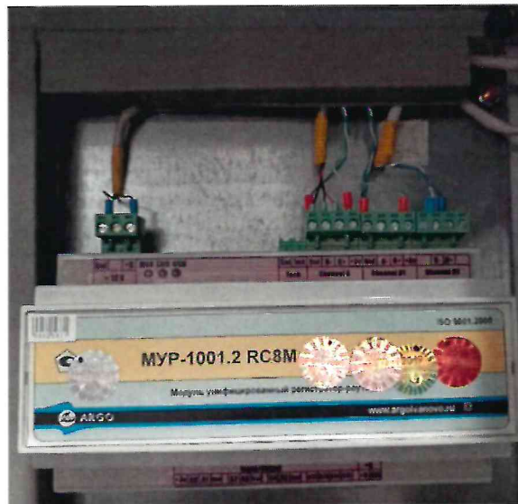
б) КИИ «МУР 1001» в шкафу АСКУЭ
