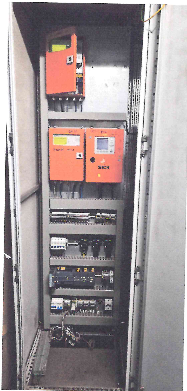
Рисунок 1.1 – Фотография шкафа вторичных преобразователей. Система автоматизированная контроля и учета выбросов № СЭ.20322.АСК.002.УХЛ1 от дымовой трубы ДСП-2 ист. выбросов № 0002. ОАО «БМЗ» № СЭ.20322.АСК.002.УХЛ1
