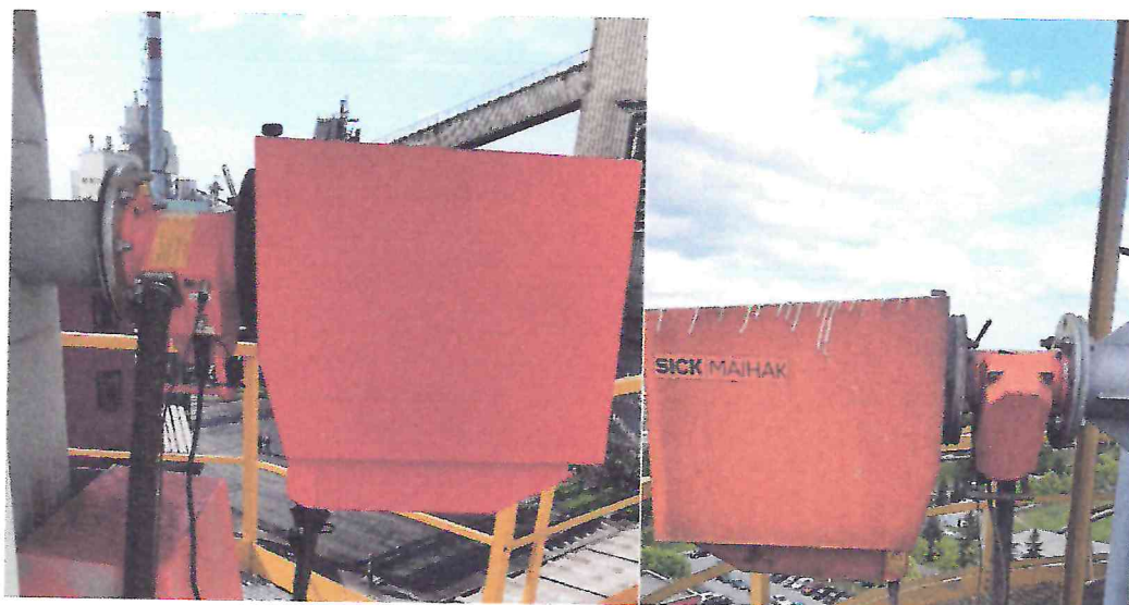
Рисунок 1.4 – Фотографии датчиков газоанализатора беспробоотборного GM31 и GM35. Система автоматизированная контроля и учета выбросов № СЭ.20322.АСК.002.УХЛ1 от дымовой трубы ДСП-2 ист. выбросов № 0002. ОАО «БМЗ» № СЭ.20322.АСК.002.УХЛ1
