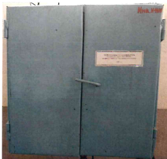
а) шкаф АСКУЭ
