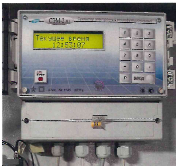
б) сумматор в шкафу АСКУЭ
