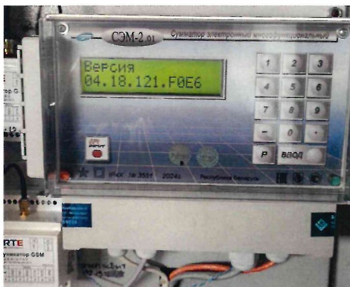
б) сумматор в шкафу АСКУЭ
