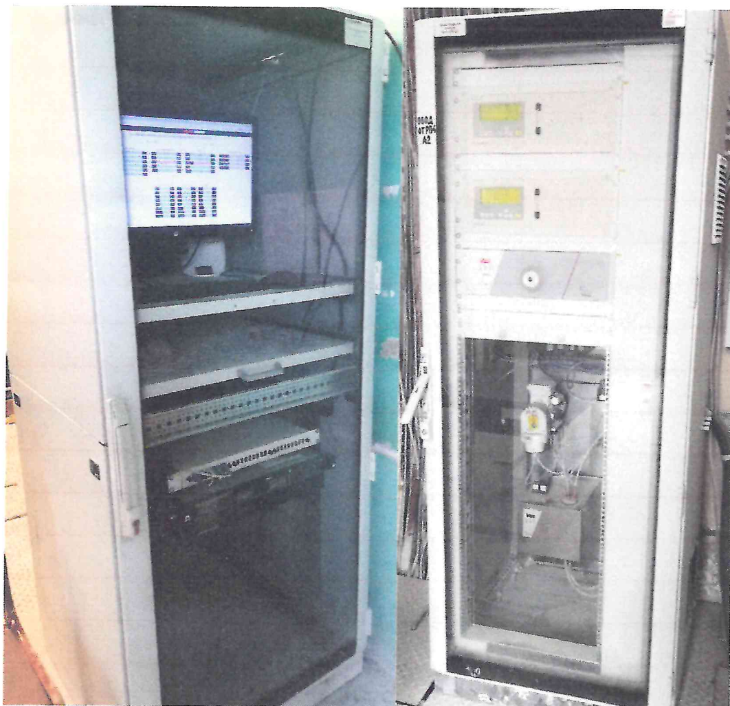
Рисунок 1.1 – Фотографии серверного шкафа и шкафа газового анализа. Система автоматизированная контроля выбросов № ECS-24.415-01
