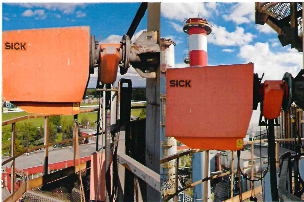
Рисунок 1.4 – Фотографии датчиков газоанализатора беспробоотборного GM31 и GM35. Система автоматизированная контроля и учета выбросов № СЭ.20322.АСК.003.УХЛ1 от дымовой трубы ДСП-2 ист. выбросов № 0765. ОАО «БМЗ» № СЭ.20322.АСК.003.УХЛ1
