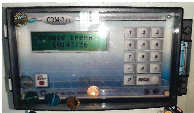
б) сумматор в шкафу учёта АСКУЭ
