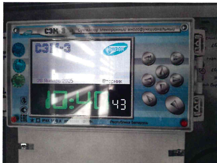
б) сумматор в шкафу АСКУЭ
