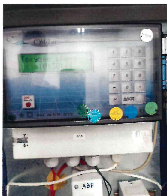
б) сумматор в шкафу АСКУЭ
