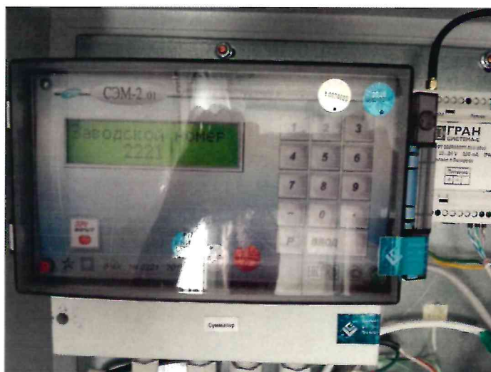
б) сумматор в шкафу учёта АСКУЭ
