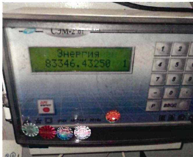
б) сумматор в шкафу учёта АСКУЭ
