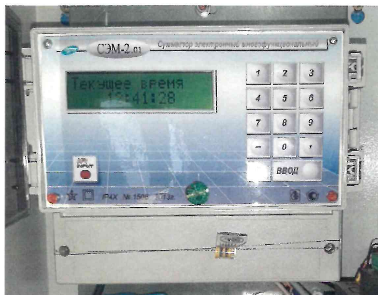
б) сумматор в шкафу учёта АСКУЭ
