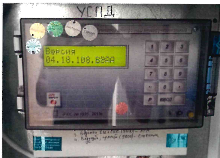
б) сумматор в шкафу АСКУЭ
