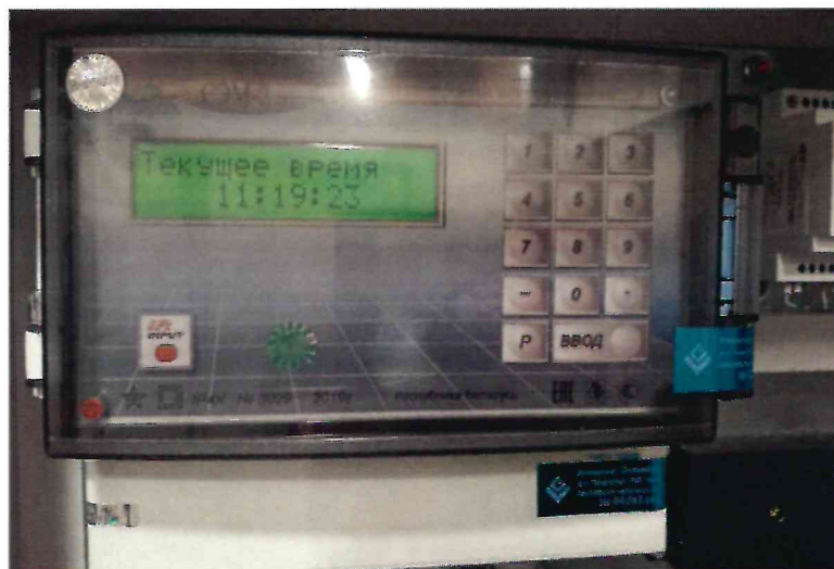
б) сумматор в шкафу учёта АСКУЭ
