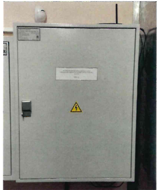
а) шкаф учёта АСКУЭ
