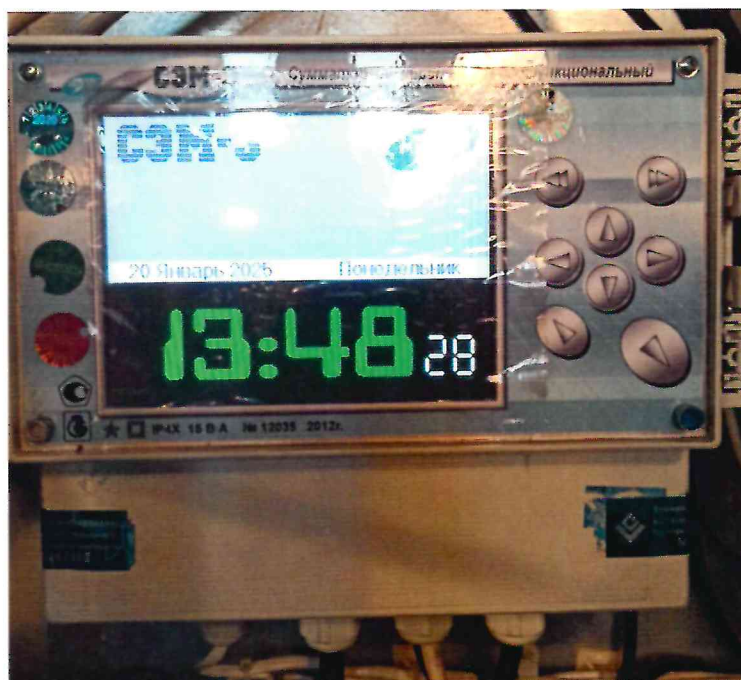
б) сумматор в шкафу АСКУЭ
