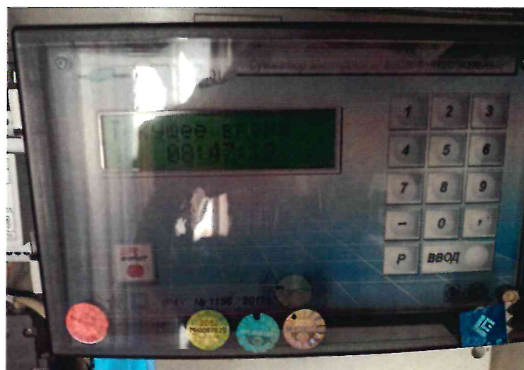
б) сумматор в шкафу учёта АСКУЭ
