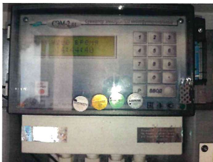
б) сумматор в шкафу учёта АСКУЭ
