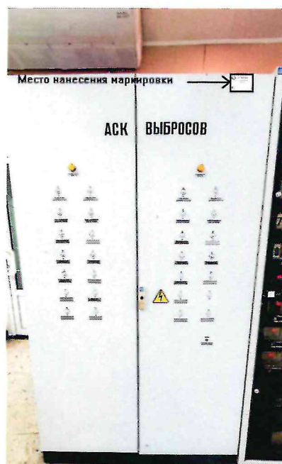
Рисунок 8 – Фотография шкафа серверного с указанием места нанесения маркировки АСКВ
