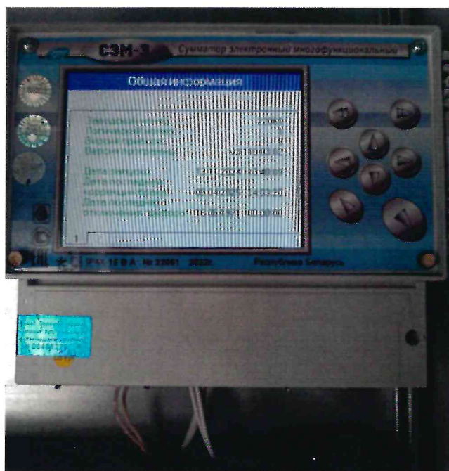
б) сумматор в шкафу АСКУЭ
